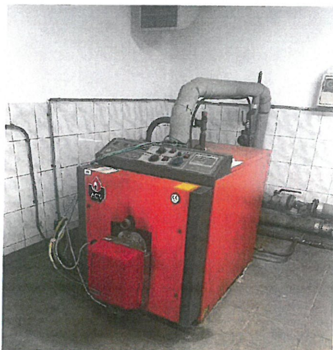
Zdjęcie 3 istniejące źródło ciepła – kocioł ACV o mocy 100 kW opalany olejem opałowym
