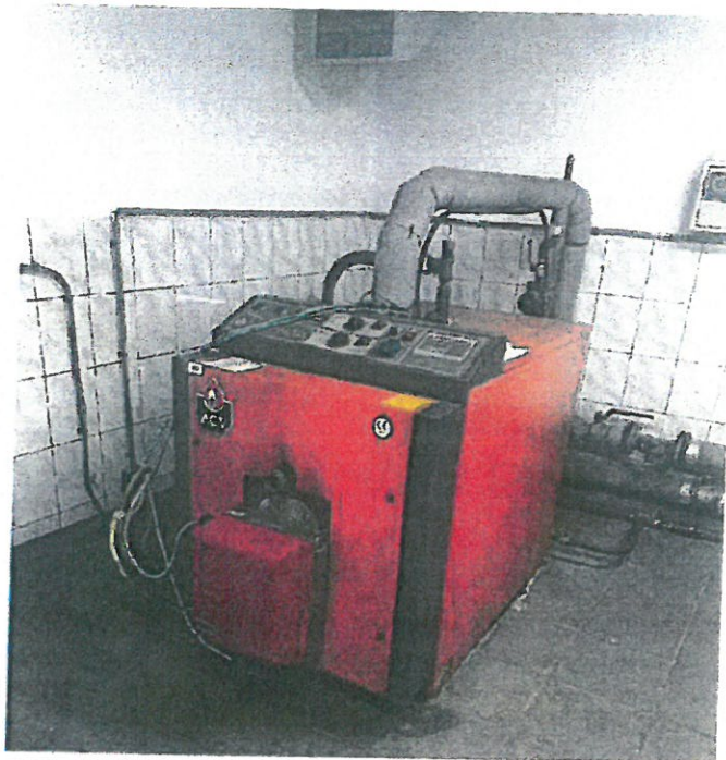
Zdjęcie 3 istniejące źródło ciepła – kocioł ACV o mocy 100 kW opalany olejem opałowym
